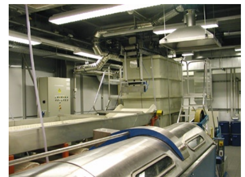
Abbildung 5 Technikumsanlage für Celluloseblasfolien
